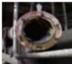
لوله فلزی خوردگی داخلی و خارجی را نشان میدهد
